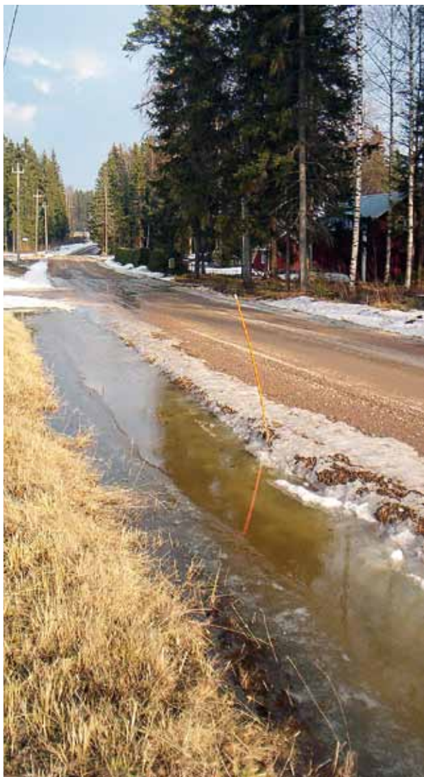
Jäässä olevan liittymärummun tielle nostama vesi on vaaraksi liikenteelle ja myös tien rakenteille.
