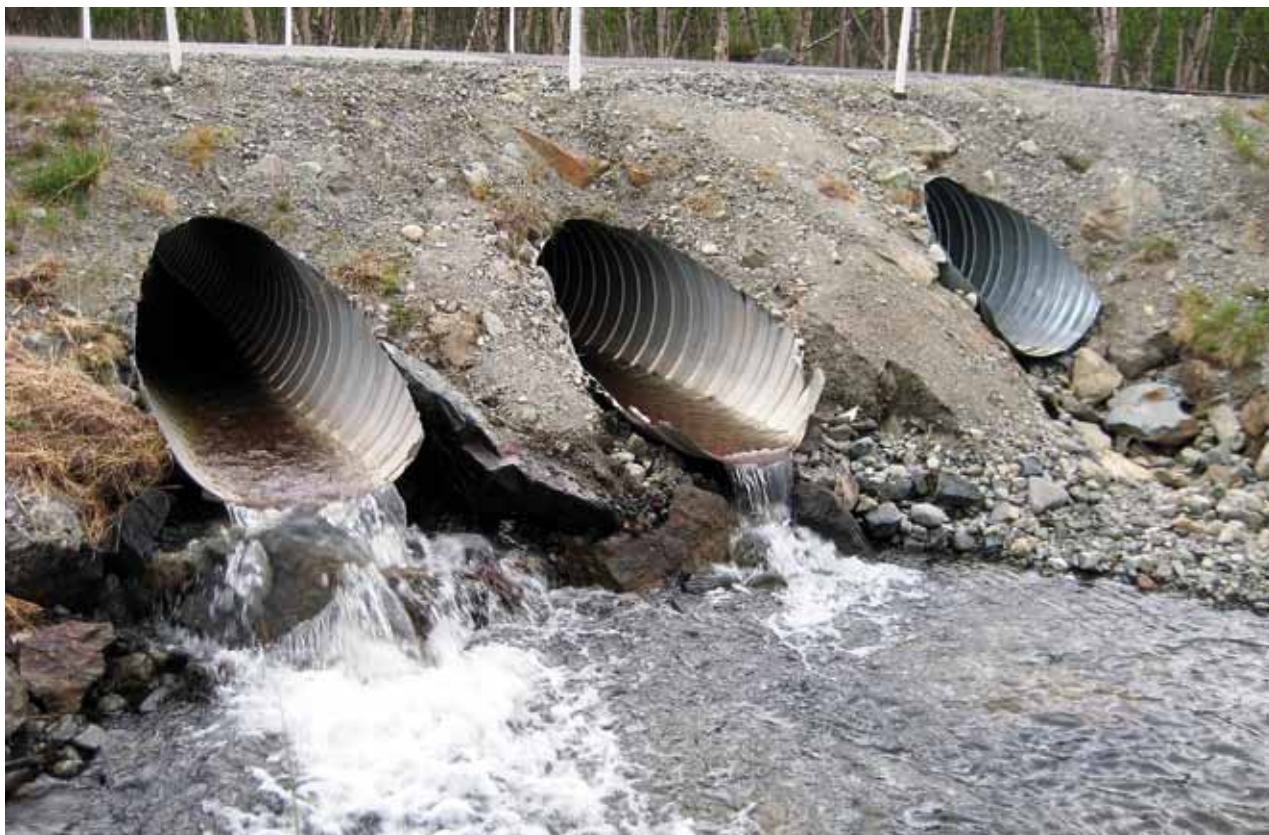
Tierummun poikkileikkaus voi olla pyöreä, ellipsin muotoinen taikka alaosaan leveämpi matalarakenteinen. Rummu voidaan tehdä myös kaksoisrumpuna.
