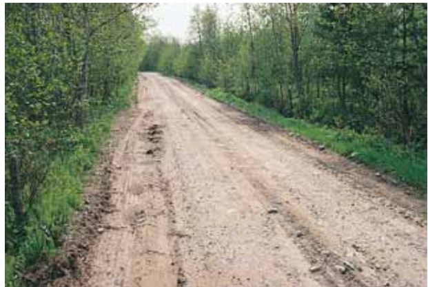
Ojat ovat huonossa kunnossa.
